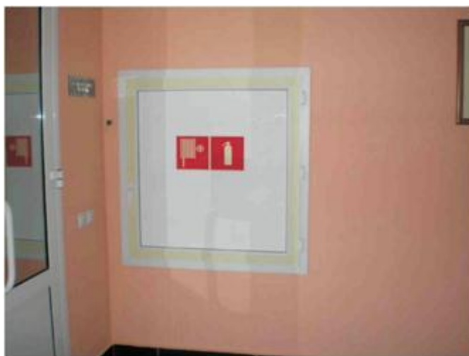
Рисунок А.6 - Обозначение фотолюминесцентной 50-мм лентой контура пожарного оборудования и использование знаков пожарной безопасности
